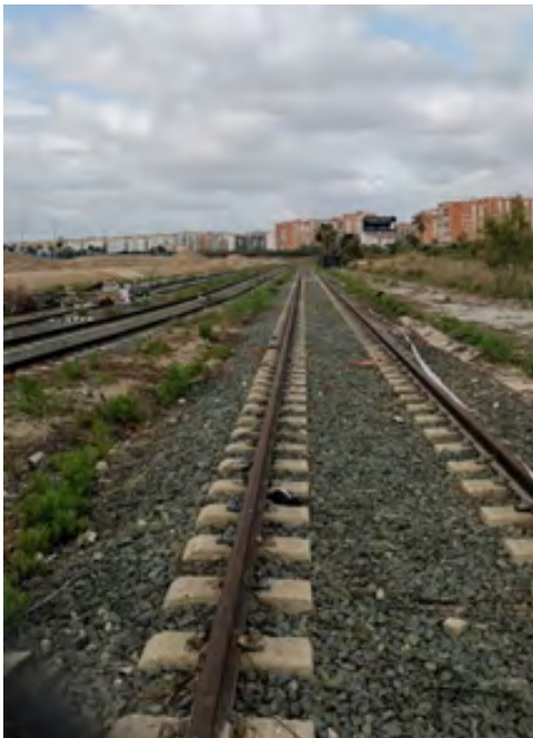
Las traviesas. Antes de madera, ahora de hormigón.
